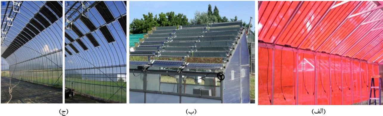
شکل ۲ روش‌های اصلی نصب پانل فتوولتائیک برای گلخانه خورشیدی؛ الف- نصب پانل به صورت ثابت بر روی سقف [۷]، ب- نصب به صورت دینامیکی و متحرک [۸]، ج- پانل‌های جدید ابداعی با قابلیت عبور نور [۹]
