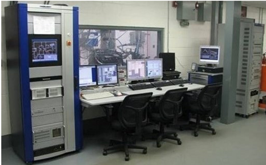
شکل ۲: تجهیزات داده برداری پر سرعت و اتاق فرمان [۱]
