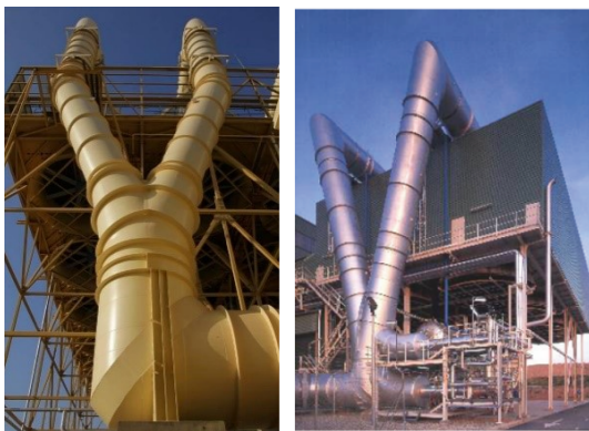
شکل ۲: قسمتی از داکت بخار ۶ کندانسور هوا خنک ایستگاه برق ۶ × ۶۶۵ مگاواتی Eskom Medupi در آفریقای جنوبی [۱۲].
