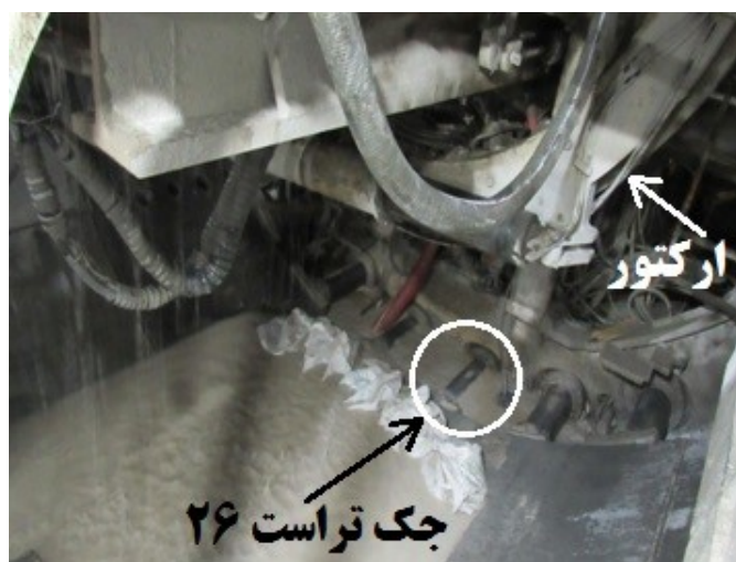
شکل ۱۶: موقعیت جک تراست شماره ۲۶. هجوم آب زیرزمینی و ریزش مصالح از روی نوار نقاله.
