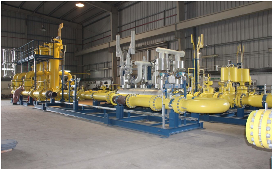
شکل ۱. ایستگاه تقلیل فشار گاز برون شهری [۱]
