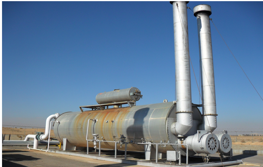
شکل ۲. گرمکن ایستگاه تقلیل فشار؛ ایستگاه هسا اصفهان
