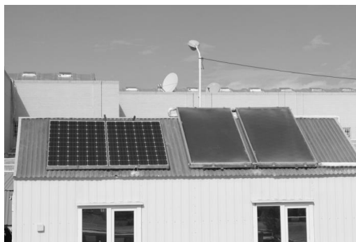
شکل ۵. کلکتورهای نصب‌شده روی سقف کانکس
