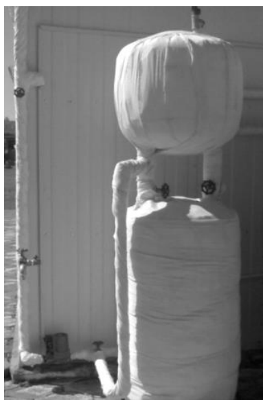
شکل ۶. مخزن‌های سیستم گرمایش خورشیدی
