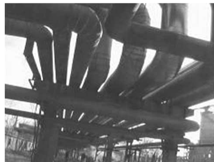
شکل ۳. خطوط لوله هوایی
