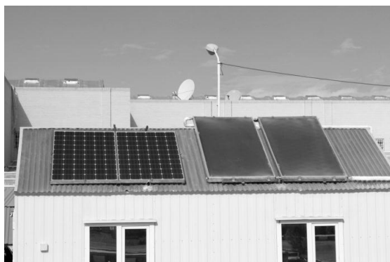
شکل ۱. کلکتورهای نصب‌شده روی سقف کانکس [۸]
