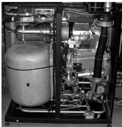
شکل ۴. نیروگاه تولید همزمان برق و حرارت شرکت انا تک [۹]
